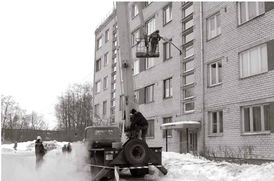
Ķekavā jumtu tīrīšana no lāstekām norit pilnā sparā. Pacēlāja izmantošana Ķekavas Namiem izmaksā ~150 latu dienā.
